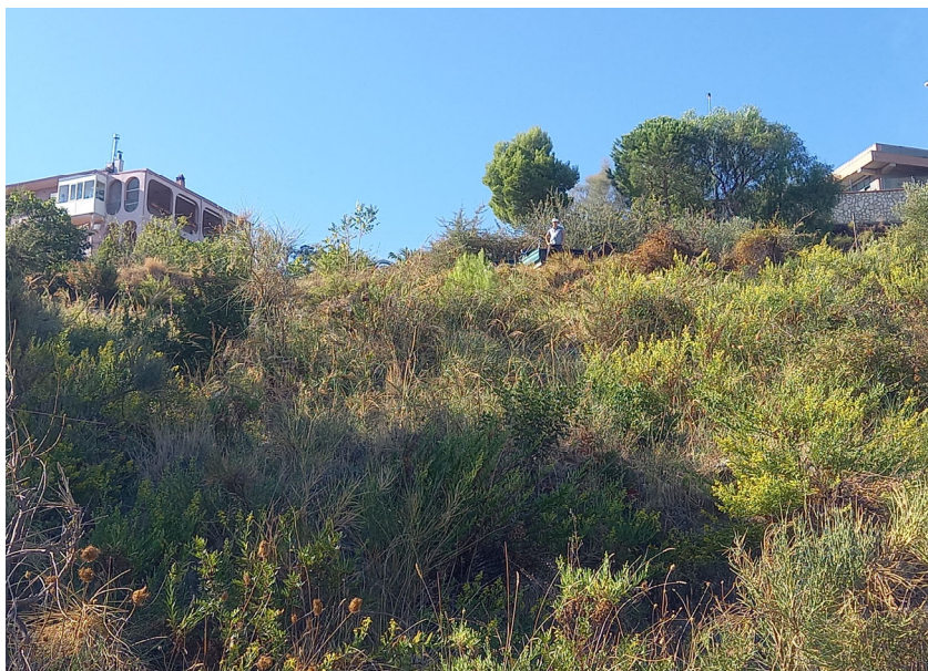
Area in frana (vista frontale)
