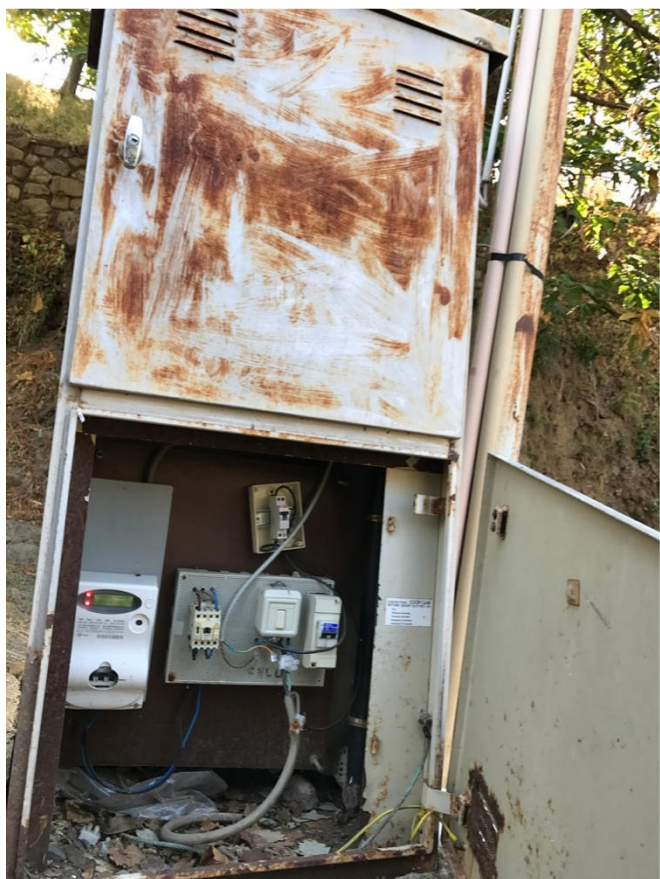
FOTO 1. - Quadro elettrico Q9
