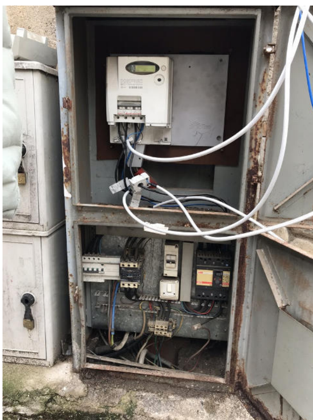
FOTO 1. - Quadro elettrico Q5
