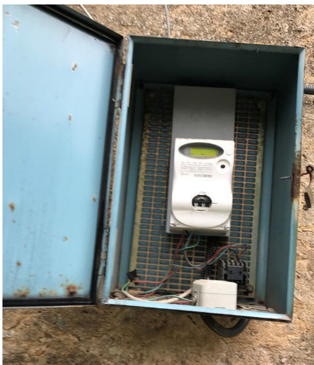
FOTO 1. - Quadro elettrico Q8
