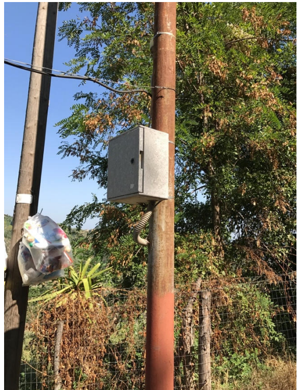
FOTO 2. – QUADRO ELETTRICO Q10.
