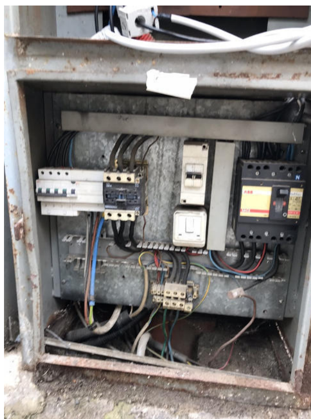
FOTO 2. - Quadro elettrico Q5
