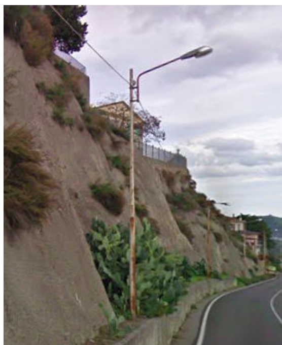
FOTO 17. - Armatura STRD LED E27 palo a braccio
