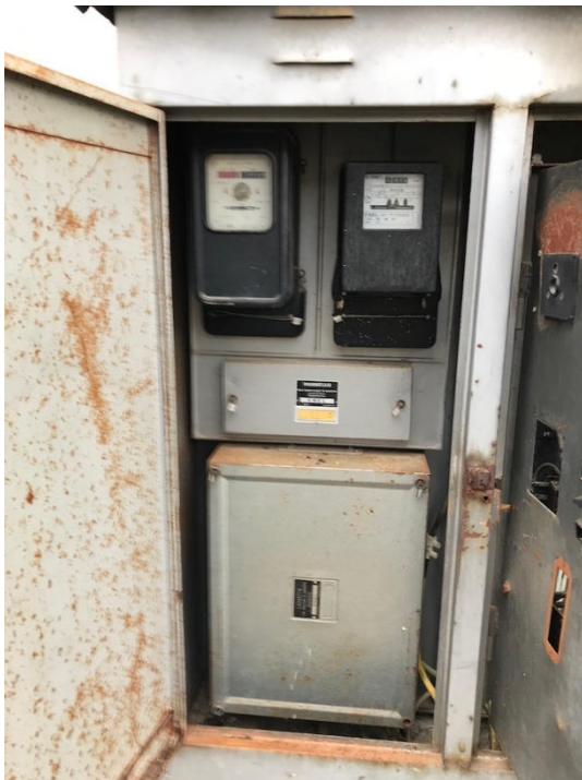
FOTO 1. - Quadro elettrico Q1
