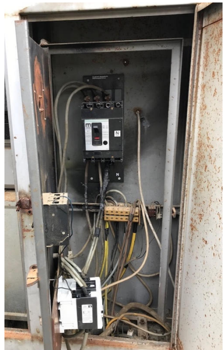
FOTO 2. - Quadro elettrico Q1
