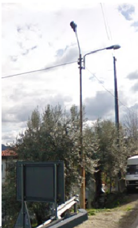
FOTO 9. – Armatura Stradale CFL DOPPIA
