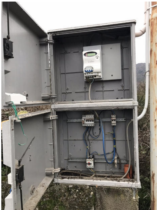
FOTO 1. - Quadro elettrico Q1
