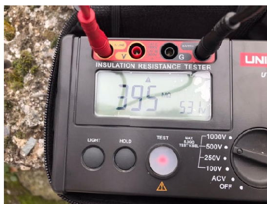
FOTO 12. – Misura della resistenza di isolamento
