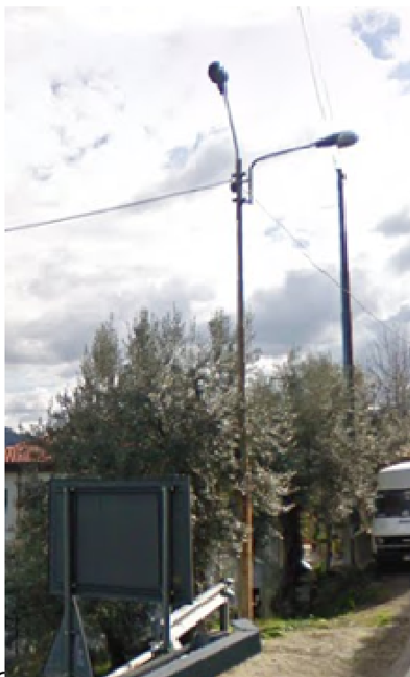
FOTO 9. – Armatura Stradale CFL DOPPIA
