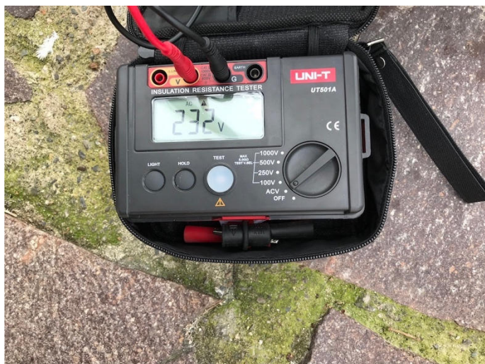
FOTO 23. – Caduta di tensione a fine linea
