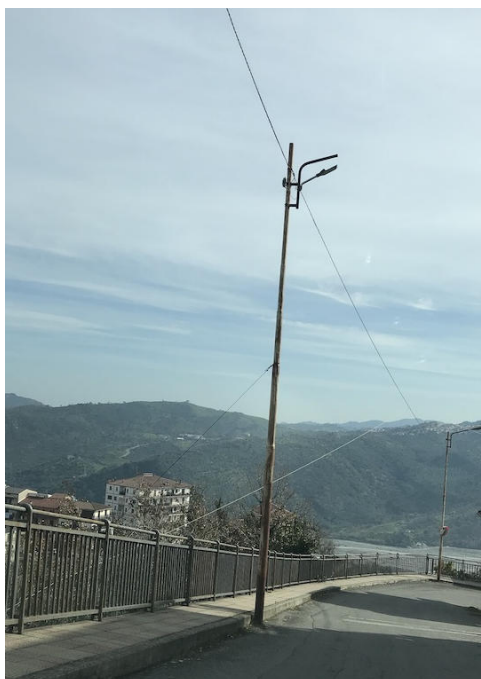
FOTO 11. – Armatura STRD Led 2 P.B
