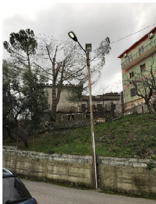
FOTO 24. – Armatura Stradale P.B. LED 1
