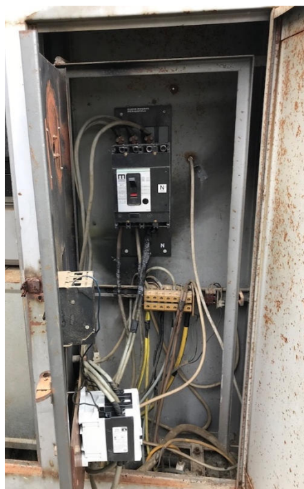
FOTO 2. - Quadro elettrico Q1
